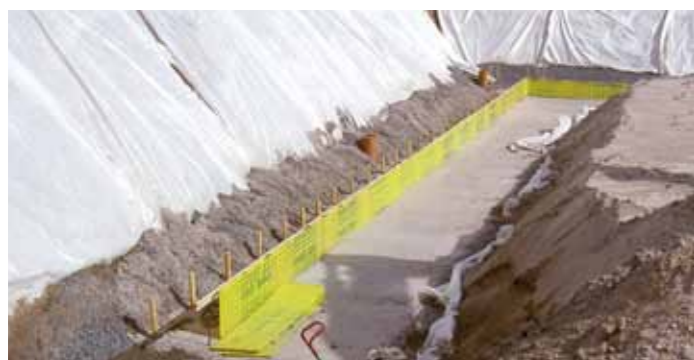
En effektivisering var att använda kvarsittande form som gjöts fast i skyddsbetongen för att senare användas till grundkonstruktionen. Det sparade tid och är lätt att arbeta med arbetsmiljömässigt.
