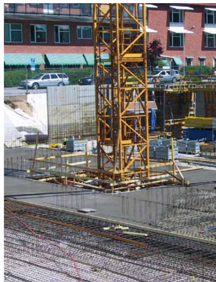
Hisschaktet förstärktes vilket innebar att en kran kunde placeras där. Detta var kostnadseffektivt eftersom man slapp använda sig av två- tre kranar över tid. Placeringen minimerade också störningar för intilliggande verksamheter med avstängda vägar och parkeringsplatser.
