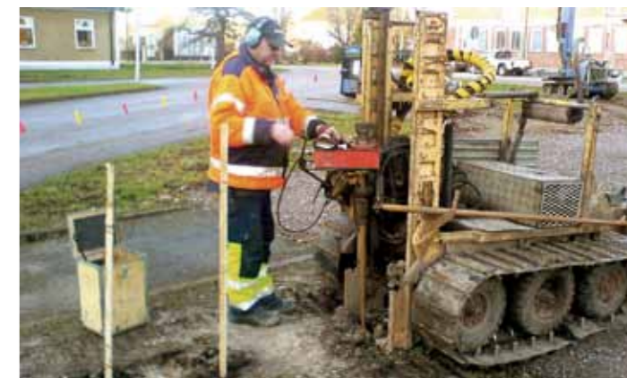
Två geologiska undersökningar gjordes som förordade pålning. Skanska genomförde en tredje undersökning i marken för hus 17 och den visade att marken inte behövde pålas om man förstärkte bottenplattan. Det gav ekonomi och tidsmässiga vinster samt minskade störningar för området.
