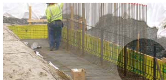
En ställning för att säkra kvaliteten vid gjutningen av vägg togs fram. Detta för att motverka genomträngning av fukt.
