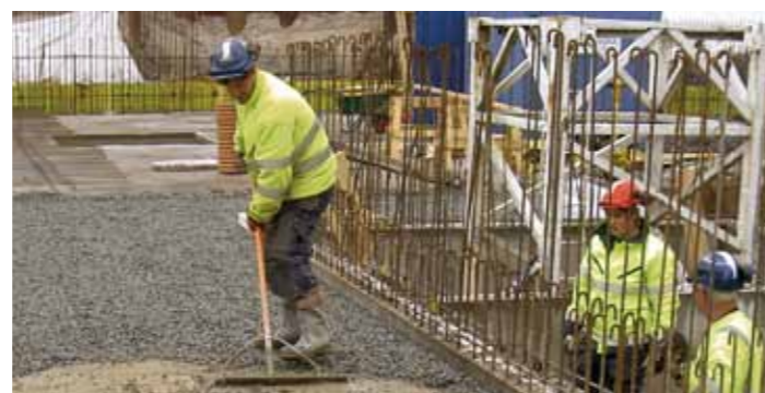
För att få rätt täcksikt på konstruktionsarmeringen användes skyddsbetong innan anläggandet av bottenplattan och väggarna. Det medförde kvalitets- och effektivitetsmässiga fördelar. Dessutom skapades en bättre arbetsmiljö.
